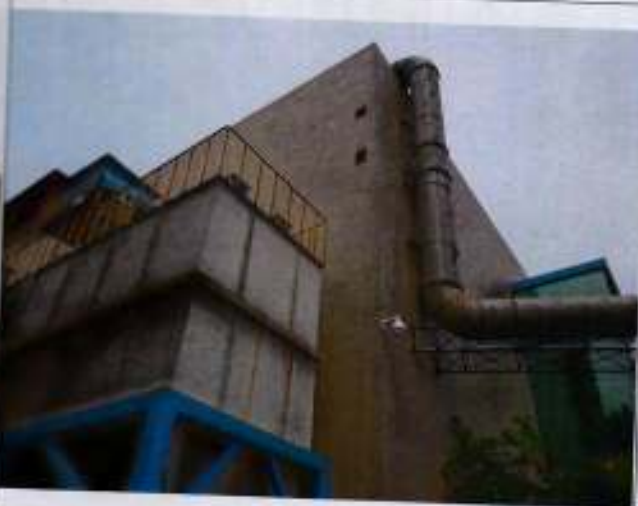
废水预处理车间处理后废气输送管道
